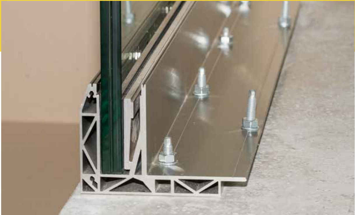
Der durchgehende Klemmstreifen ist gut zu erkennen.
